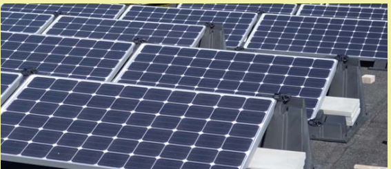
PV-System ca 200kWp gesamt davon ca. 25kWp für Hallenbeleuchtung
